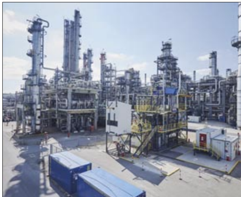
Impianto pilota ReOil di OMV in Austria
