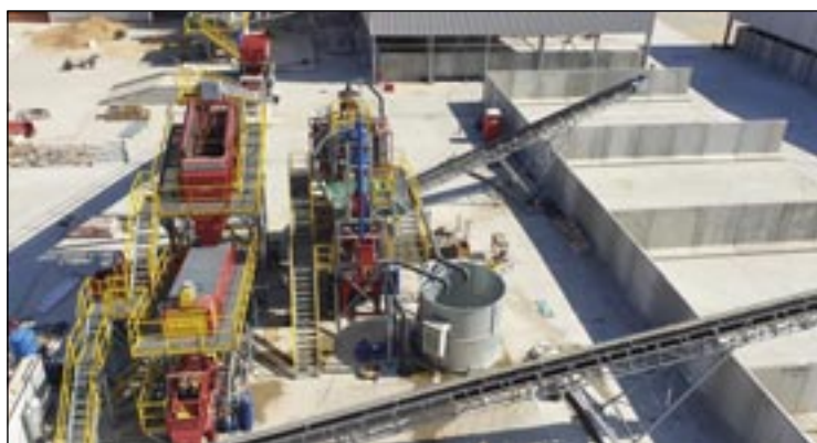
Impianto di soil washing stazionario
