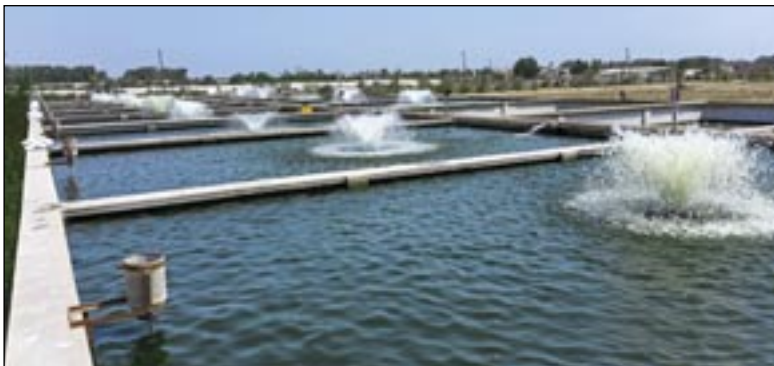
Serie di aeratori superficiali verticali mod. SPLASH installati in bacini di depurazione
